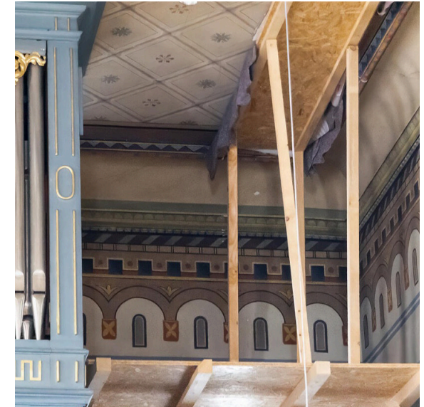
Abgestützte Decke am Aufgang zur Orgel
