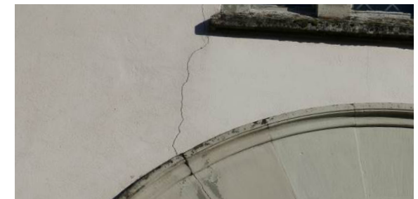
Risse an der Westseite der Kirche
