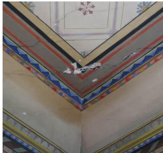
Risse an der Randwölbung Nord-Ost
